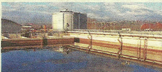
Oczyszczalnia ścieków w Żywcu – jedna z komór reaktora C-Tech.
