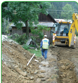
GMINA KOSZARAWA Kontrakt 17 – Kontrakt zakończony Zakres prac: 46 km sieci kanalizacyjnej Wartość Kontraktu: 18 981 883 zł brutto
